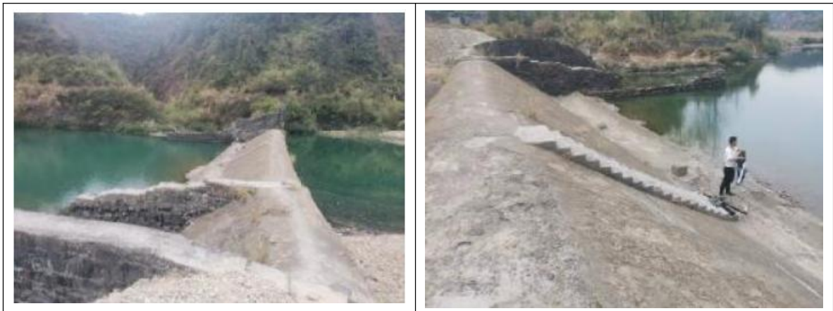
图 3.3-1 固定堰现状表层破损，缝隙内长有杂草
