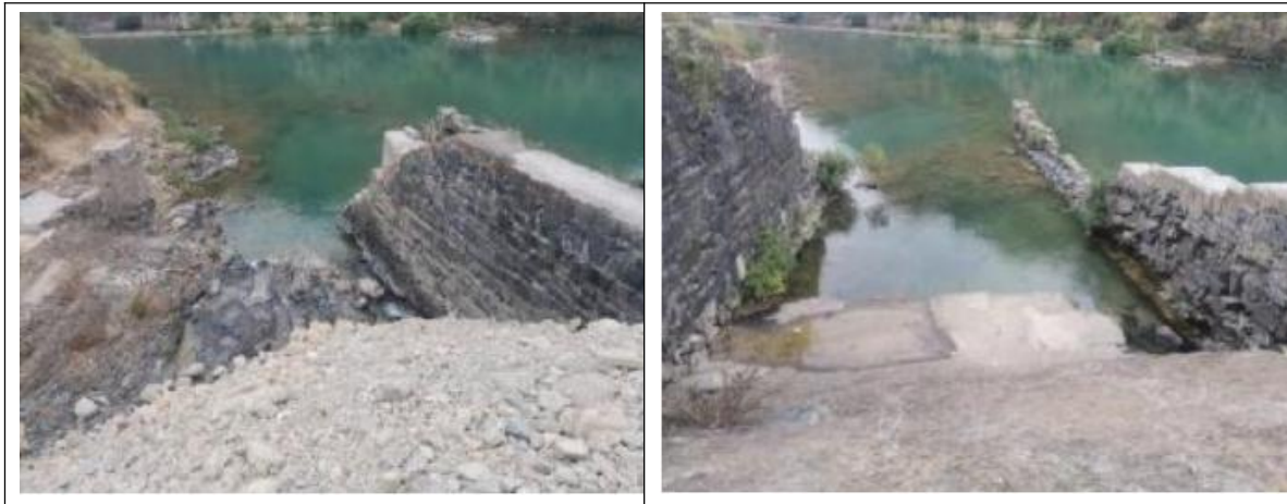
图 3.3-3 左岸冲垮部位砂石堆砌，挡墙倒塌，底部冲刷，漏水严重
