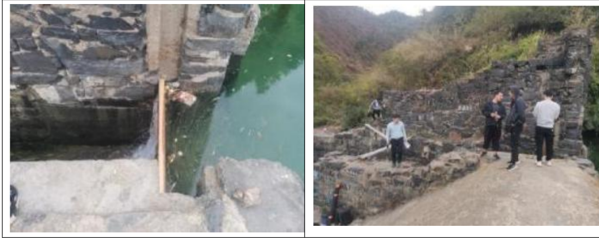
图 3.3-2 右岸泄水闸闸门丢失，上部墙体破损严重
