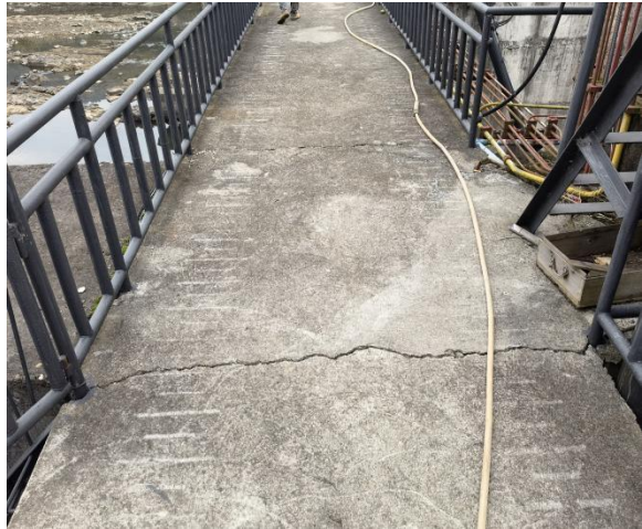
工作桥现状（裂缝2）
