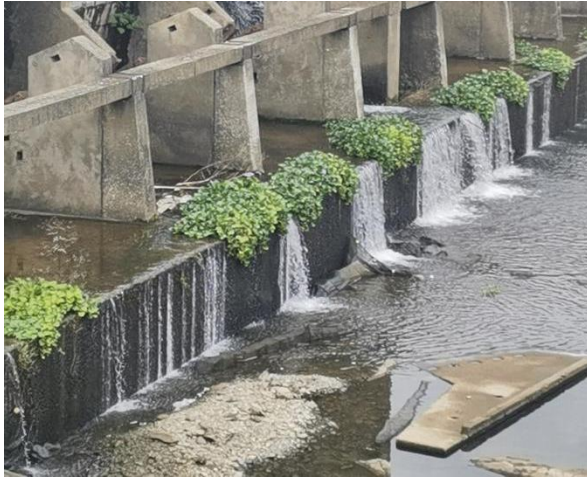
翻板闸闸门（往年破损闸门）
