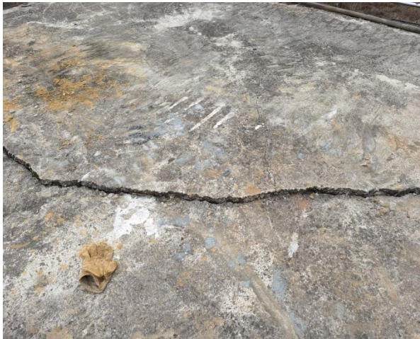
路面开裂细部
