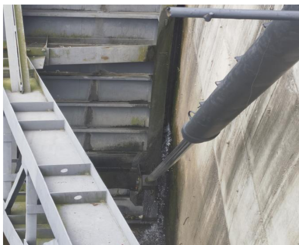
2#弧形闸门（漏水）
