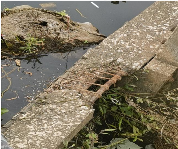
1#水力自控翻板坝（混凝土剥蚀、钢筋外露、锈蚀严重）
