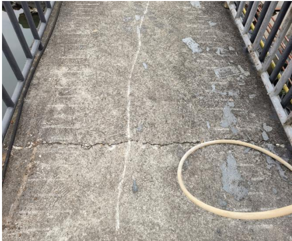
工作桥现状（裂缝1）
