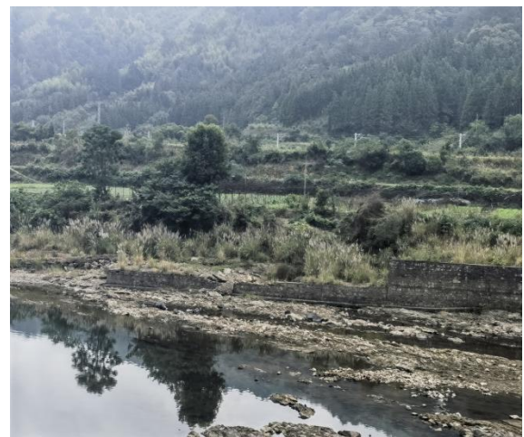
右岸下游挡墙（上部损毁）
