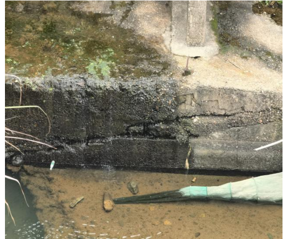
坝体（横向裂缝、坝脚掏空）
