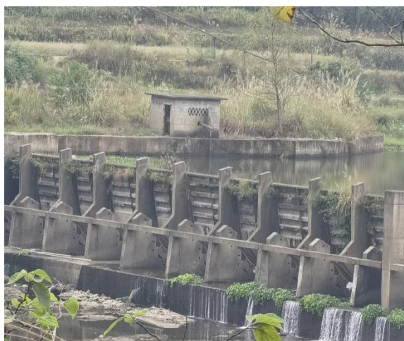
水力自控翻板坝（漏水）
