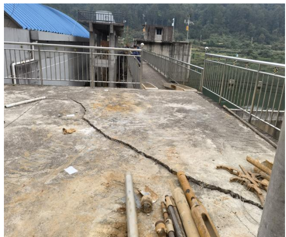
非溢流坝段路面现状（开裂）
