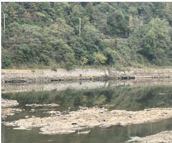
左岸下游挡墙（下部掏空）
