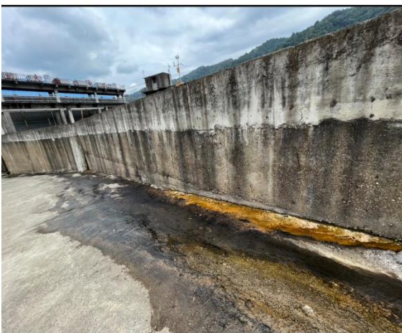
进厂道路现状（轻微渗水）
