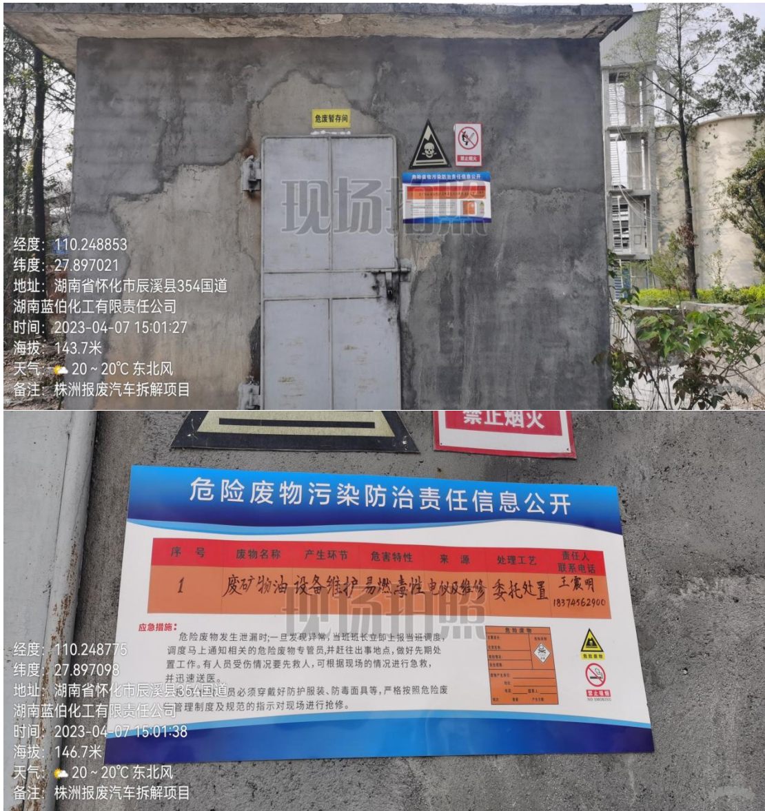
图 7.2-1 现有危险废物暂存间
