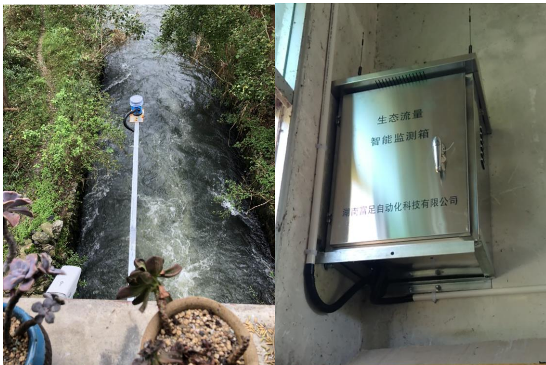
图3.3-2 已安装的生态流量监控设备
