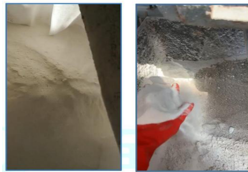
添加 DY-01 添加剂后急冷塔结盐
