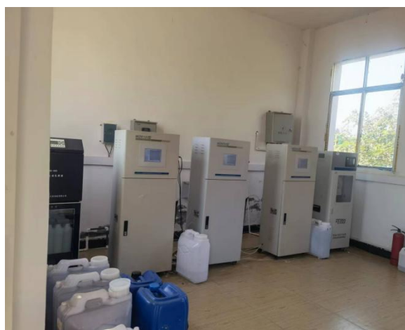
废水出口在线监测设施
