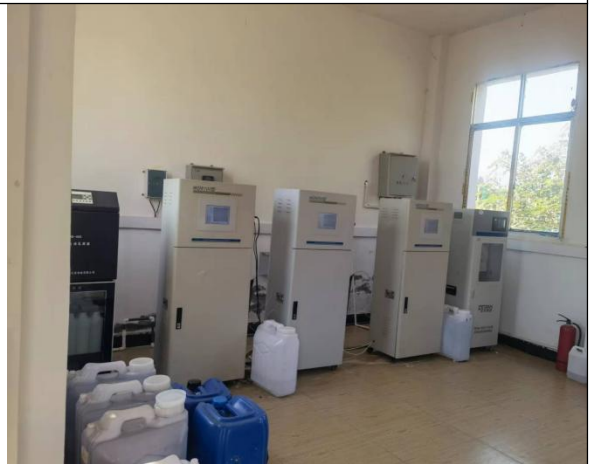
废水出口在线监测设施
