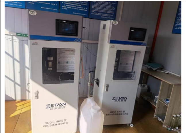
废水进口在线监测设施
