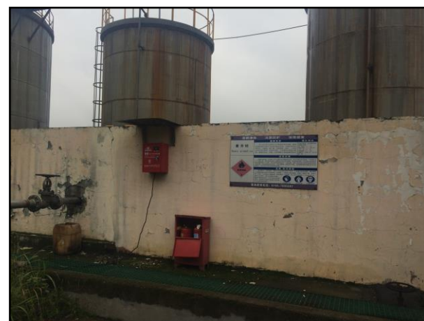
重芳烃及工作液储罐 (7#~10#)
