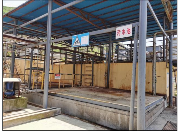
厂内污水处理站
