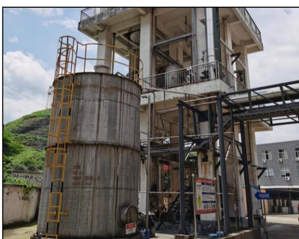
浓缩装置及 12#成品储罐（本项目利用）
