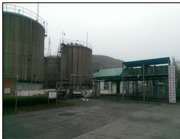
成品过氧化氢储罐区 (1#~4#)
